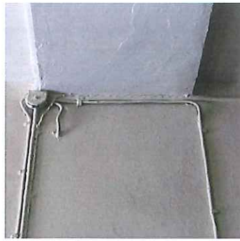
Elektroverkabelung im Rathaus Rethem
